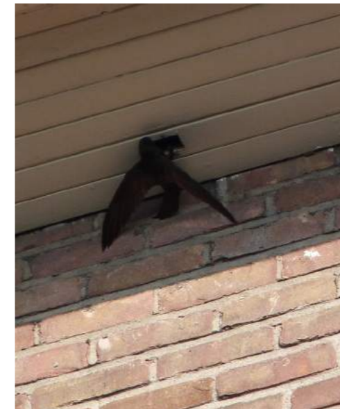
Gierzwaluwsteen weggewerkt in dakrand
